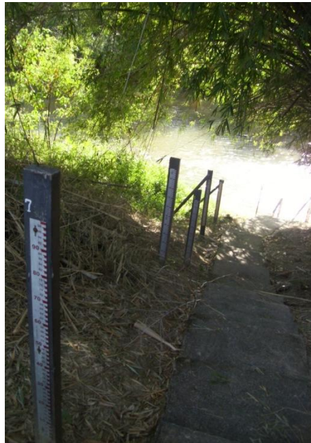
Figura 7.24 – Réguas linimétricas para monitoramento das vazões do Rio Taquaraçu nas dependências da Arcelormittal
