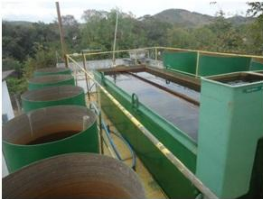
Figura 7.54 – Tratamento de água no município de Taquaraçu de Minas
