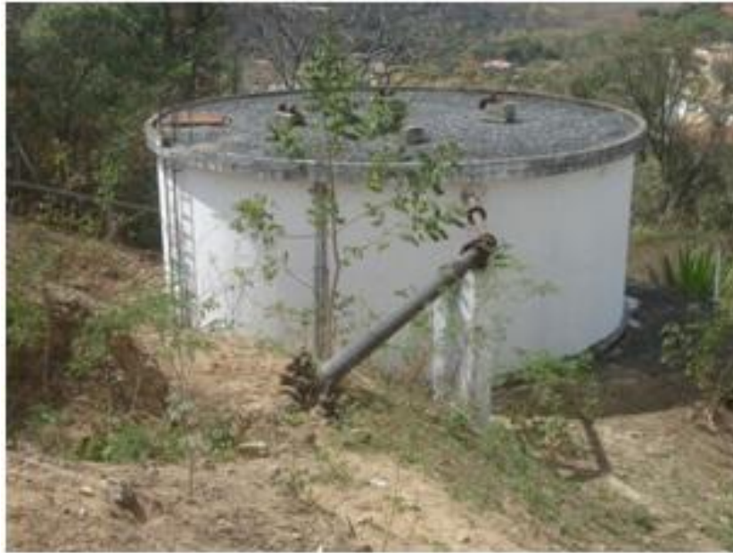
Figura 7.56 – Reservatório apoiado da COPASA – sede municipal
