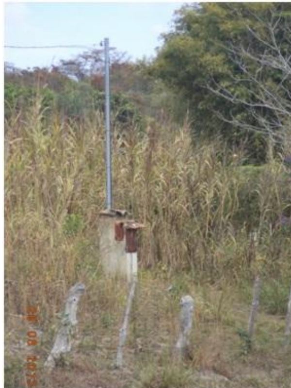
Figura 7.66 – Poço artesiano de Campo dos Coelhos
