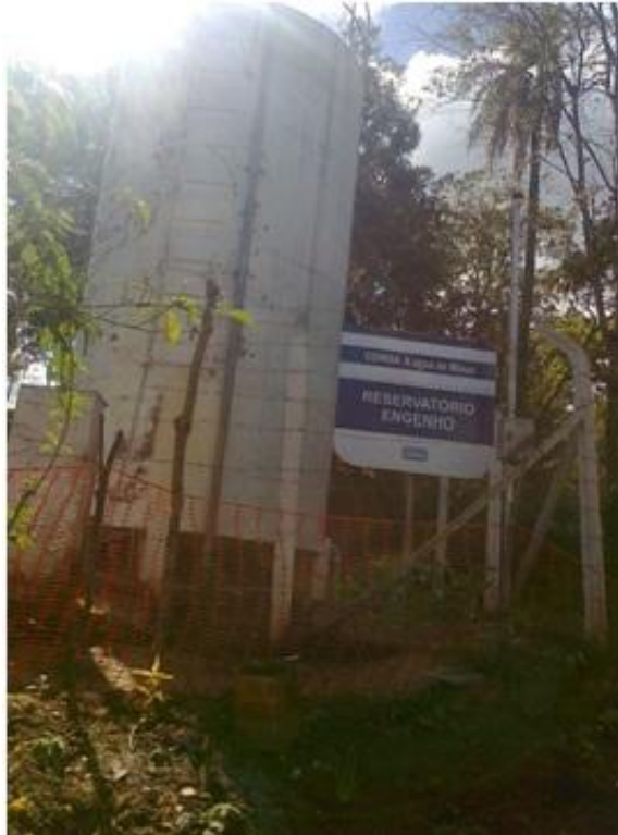
Figura 7.65 – Reservatório de água do Sistema Engenho (50m 3 )
