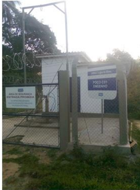
Figura 7.63 – Poço C01 do Sistema Engenho
