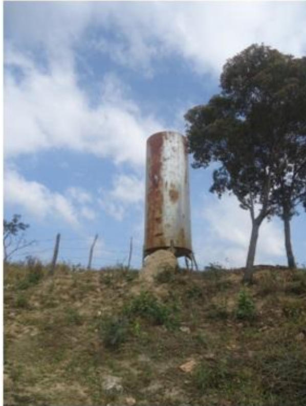
Figura 7.67 – Reservatório de água de Campo dos Coelhos
