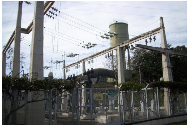
Figura 7.21 – Usina de energia elétrica da Arcelormittal em Taquaraçu de Minas
