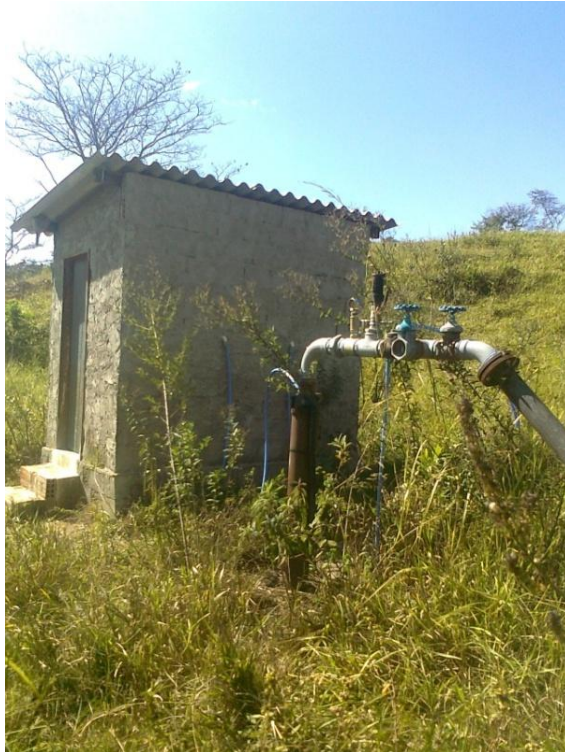
Figura 7.60 – Poço tubular profundo do sistema Ferreira Fonte: COPASA (2013).
