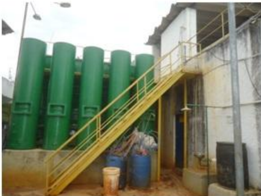
Figura 7.55 – Sistema de filtros da ETA
