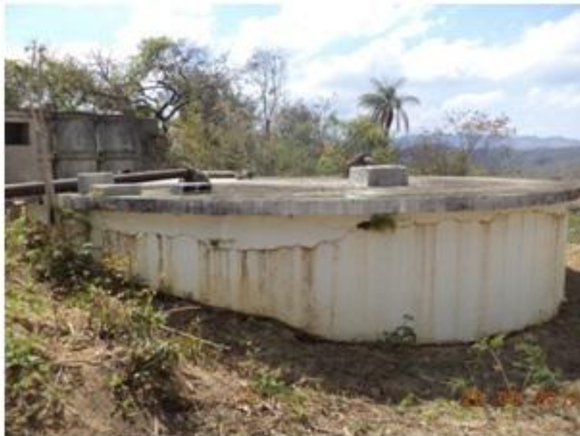
Figura 7.57 – Reservatório semi-enterrado da COPASA– sede municipal
