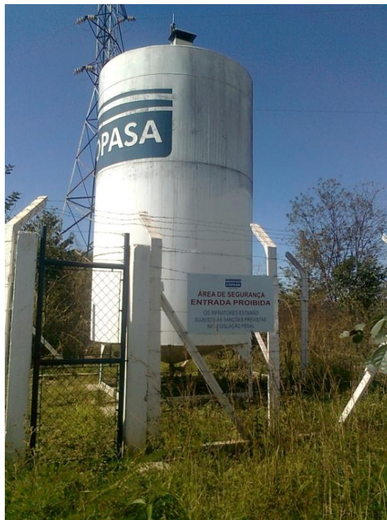
Figura 7.61 – Reservatório do sistema Ferreira (20 m 3 ) Fonte: COPASA (2013).
