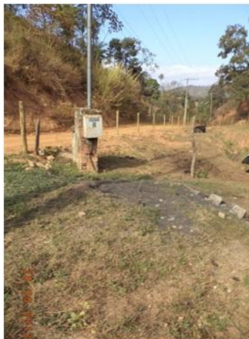
Figura 7.68 – Poço artesiano de Casas Velhas Fonte: COBRAPE (2013).
