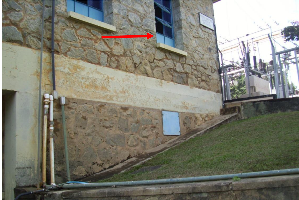
Figura 7.26 – Indicação do ponto até onde chegou o nível de água do Rio Taquaraçu junto às instalações da Arcelormittal
